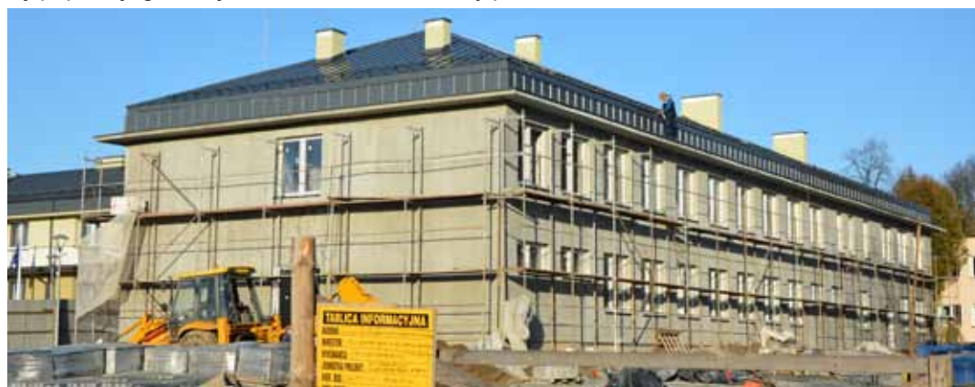
Pod jednym dachem będzie się mieścić GOPS i Dzienny Dom Pobytu dla Osób Starszych
