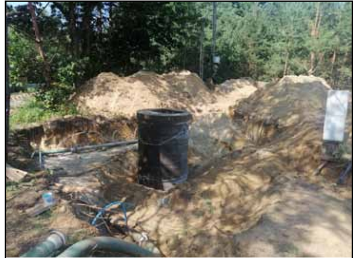
Studnia polimerobetonowa przepompowni ścieków
